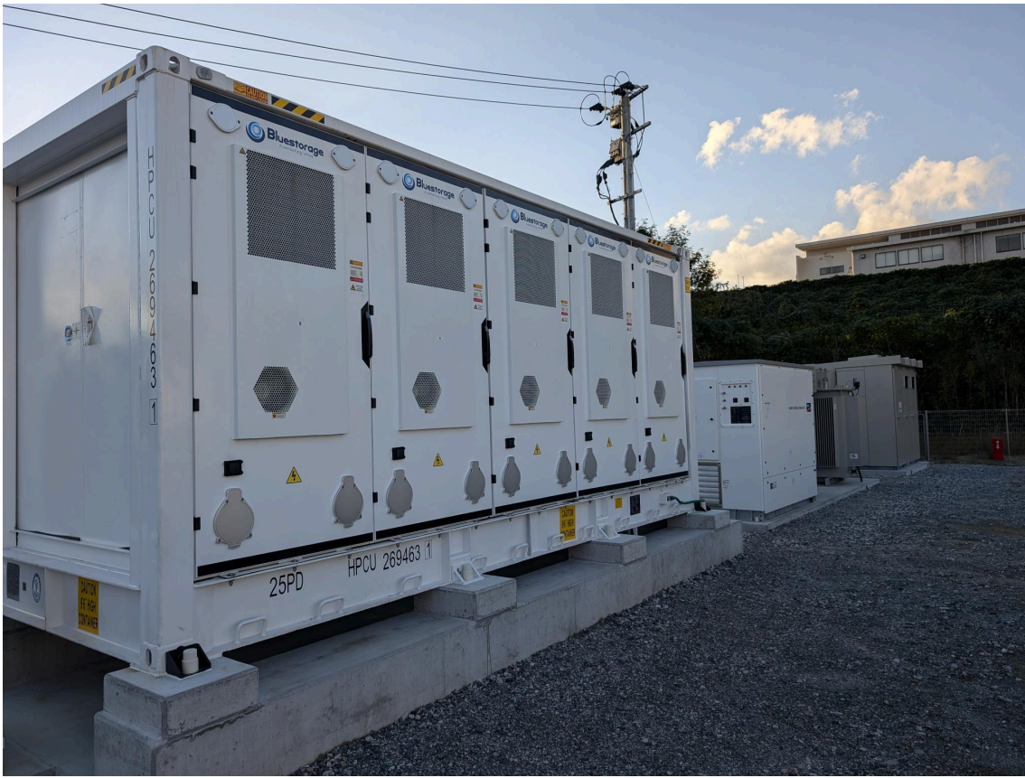
【西鉄自然電力バッテリーハブ飯塚 写真】
